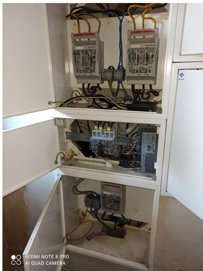
Rozdzielnica główna w klatce 11A – do uzupełnienia o nową aparaturę
