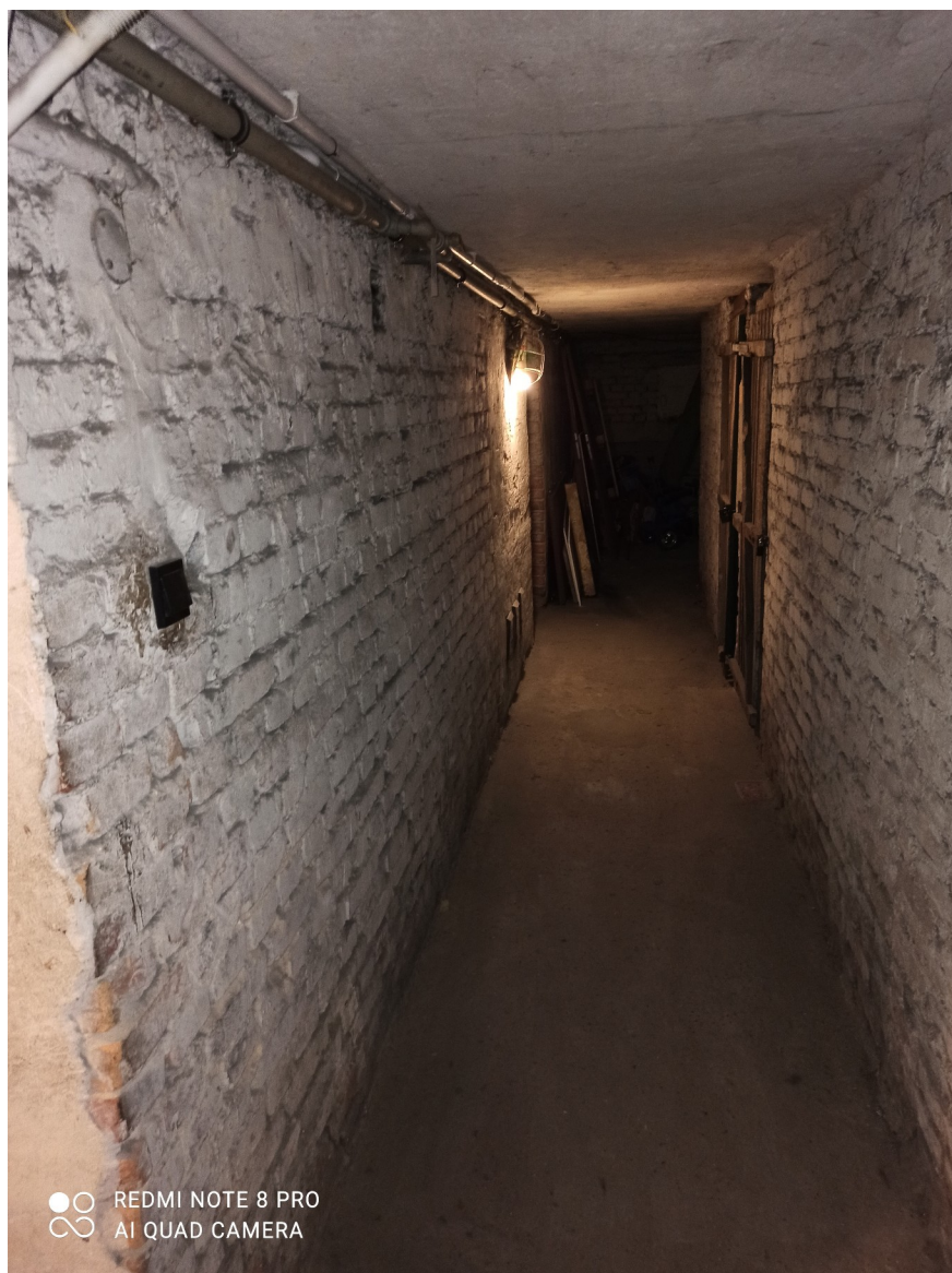
Oświetlenie piwnic – do przebudowy
