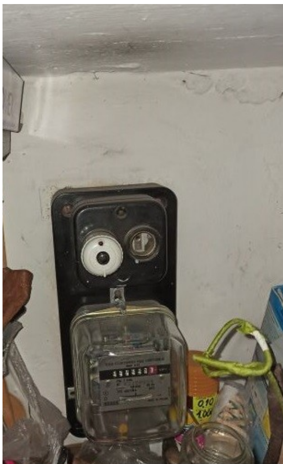
Przykładowy licznik lokalowy z zabezpieczeniami – do wyniesienia na klatkę
