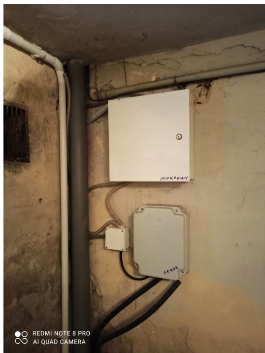
Zasilanie bramy i domofonów piwnica kl.11 – do przełączenia pod nowe zasilanie
