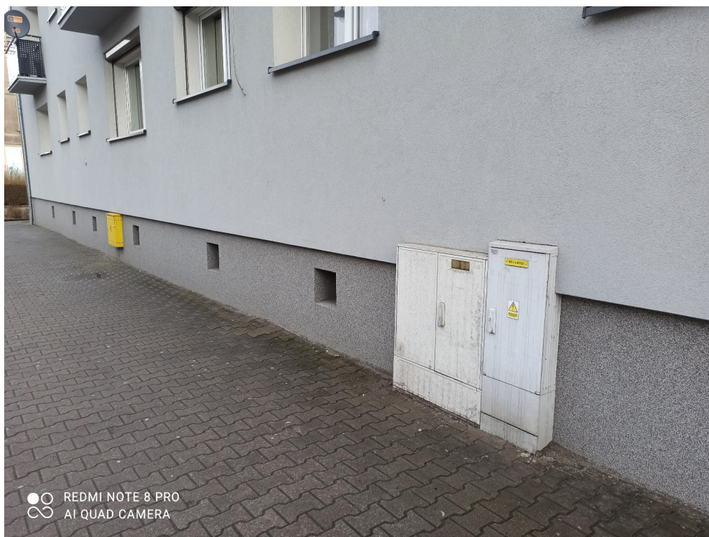
Złącze kablowe na elewacji frontowej budynku
