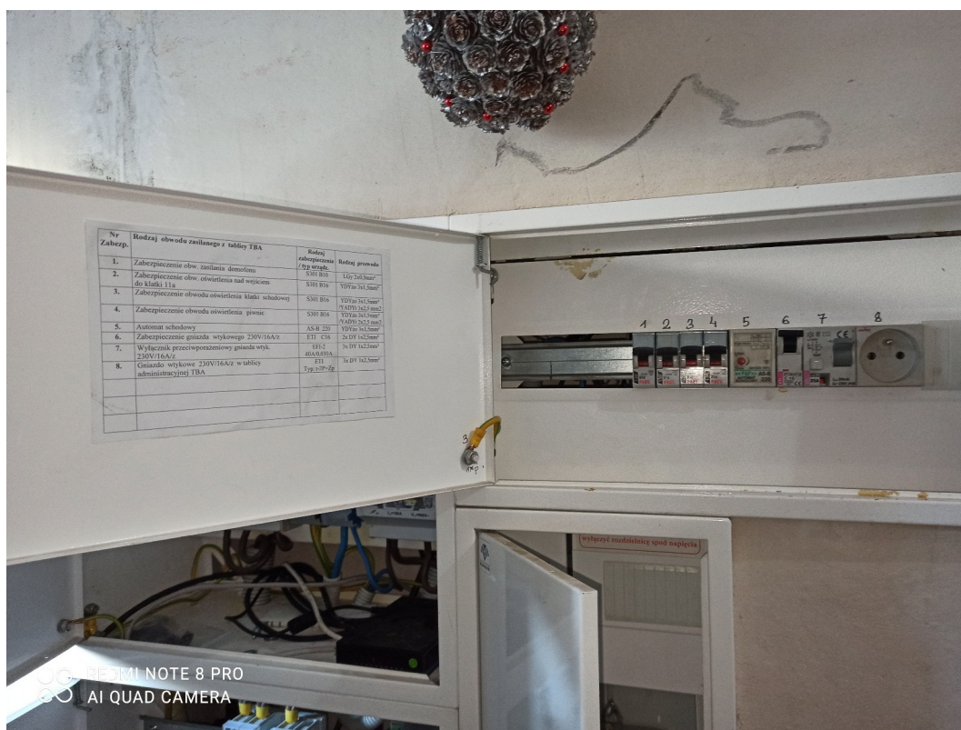
Część administracyjna rozdzielnicz gówniej kl. 11A – do uzupełnienia o nową aparaturę
