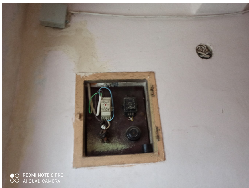
Rozdzielnicz administracyjn kl. 11 – do wymiany
