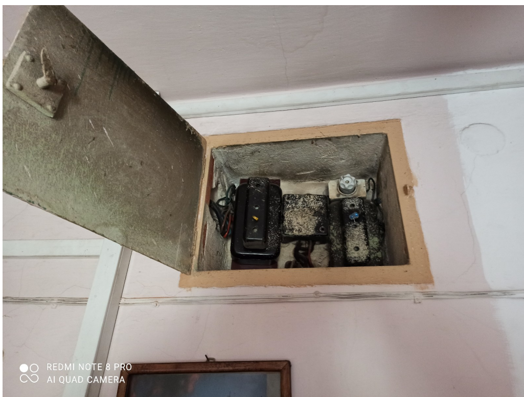
Zabezpieczenia przedlicznikowe lokali kl. 11, 11A – do wymiany
